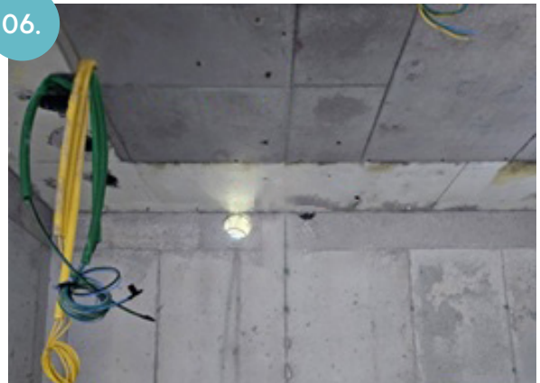
슬리브 매립 설치 불량
