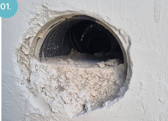
콘크리트 잔여물 유입
