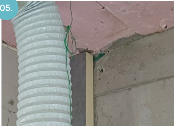
슬리브 매립 설치 불량
