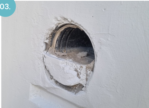
콘크리트 잔여물 유입
