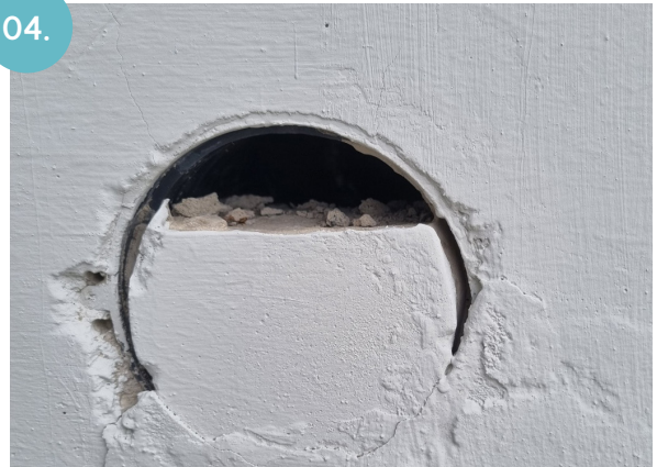
콘크리트 잔여물 유입
