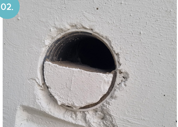
콘크리트 잔여물 유입
